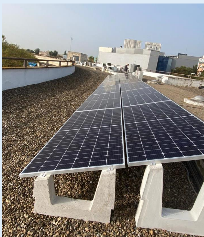
Instalación fotovoltaica de 20,00 kWp en Notaría Luis Barriga (Mairena del Aljarafe).
